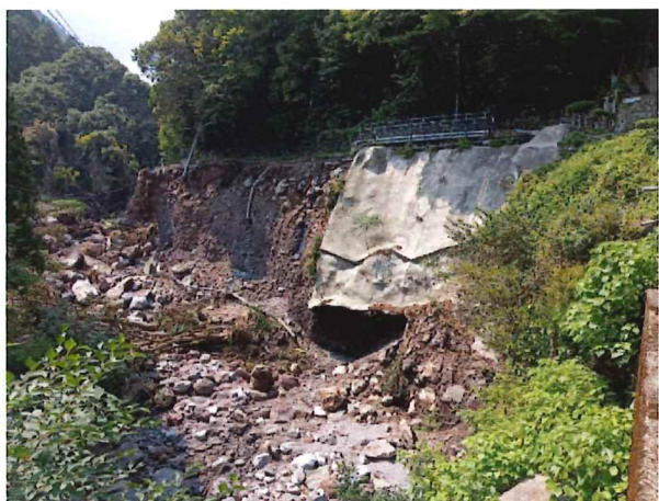
【堀田地区崩落現場】
